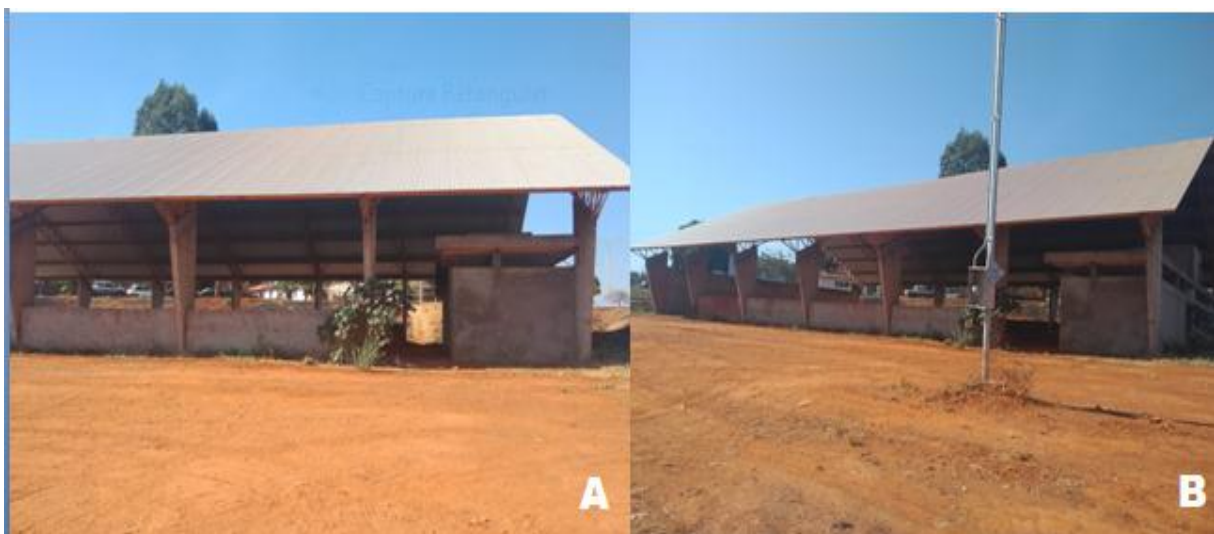
Figura 08: Registro fotográfico do Ginásio de esportes inacabado encontrado no território de abrangência Residencial Marise, Trindade/GO, Brasil, 2019.
