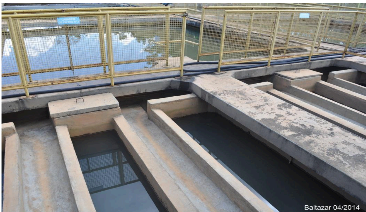
Figura 2: Sistema de tratamento de água de Inhumas Fonte: Baltazar, 2014
