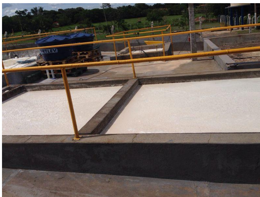
Figura 08: Tanques de Separação. Fonte: Foto retirada pelas autoras do trabalho.
