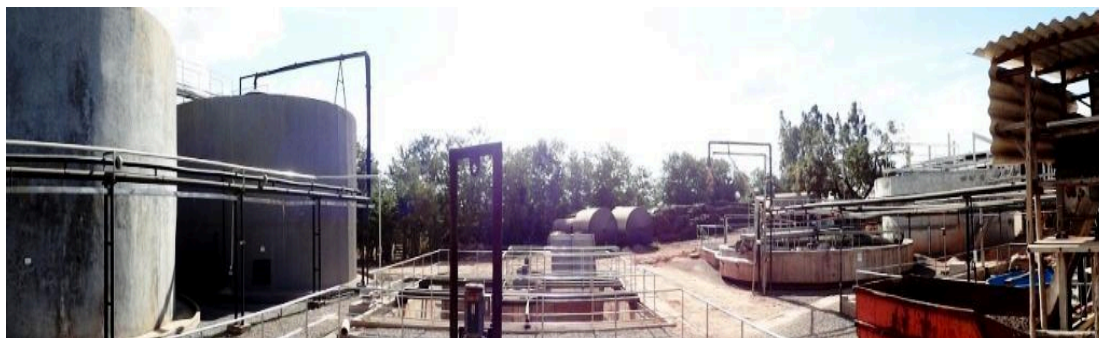
Figura 3. Estação de Tratamento de Efluentes, Gelnex 2013.
