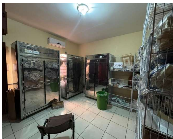
Figura 5 - Sala de armazenamento de medicamentos frios
